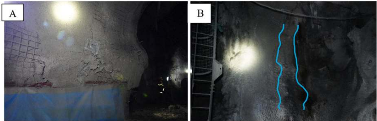
Gambar 3 Unravelling Shotcrete di Area Bottom Chamber (Gambar A) dan Tetesan Air Tanah di Dekat Vertical Raise (Gambar B) (Dokumentasi Pribadi)
